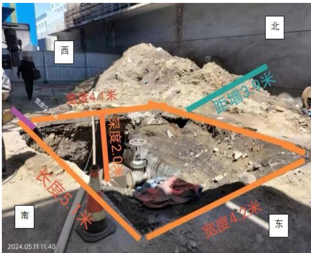
事故现场照片
